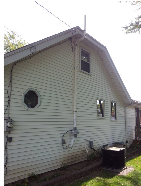
Exterior fan and vent stack
